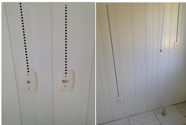
Exemplo de instalações
